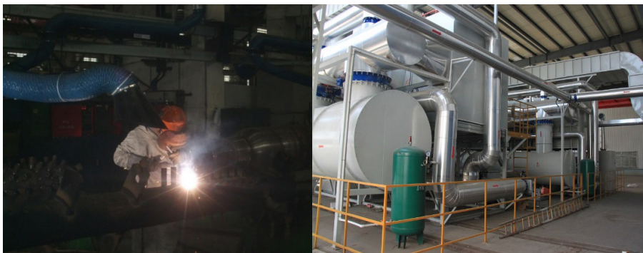
焊接烟尘净化装置 VOC 综合治理装置
